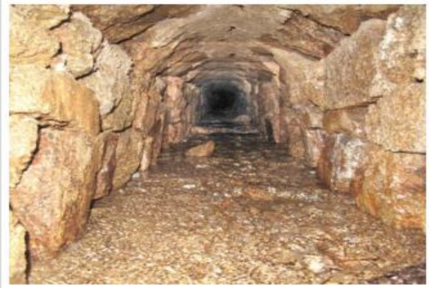
Source photos : Collectivité eau du bassin rennais
