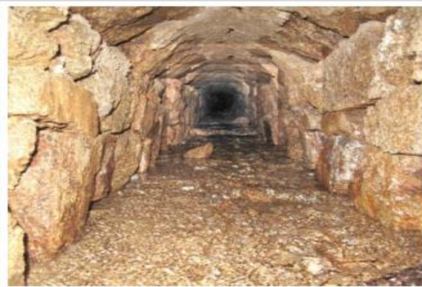
Source photos : Collectivité eau du bassin rennais
